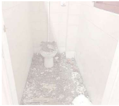
Il precedente A dicembre è caduta una parte del controsoffitto
